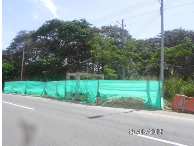
PR18+130 Estado actual, costado izquierdo puente peatonal La Esmeralda
