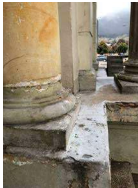
Figuras 139: Deterioro basa de columna pórtico sur. Fuente: Fotografía consultoría NVP arquitectos 2018.
