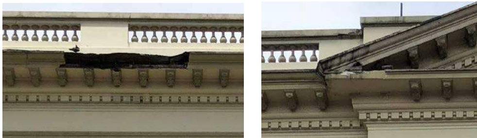
Figuras 140 y 141: Desprendimiento de elementos decorativos en la fachada occidental.
