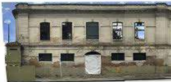
Figura 92: Cuerpo sur fachada oriental edificio "La Flauta" Fuente: Fotografía Consultoría NVP arquitectos 2018.
