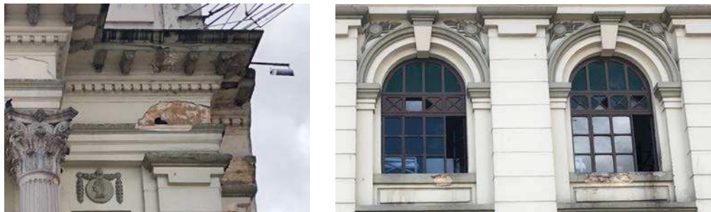
Figura 142 y 143: Desprendimiento de elementos en la fachada sur.
