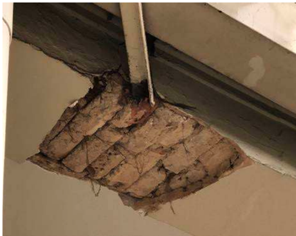
Figura 135: Pérdida de pañete en viga de patio sur. Fuente: Fotografía consultoría NVP arquitectos 2018.
